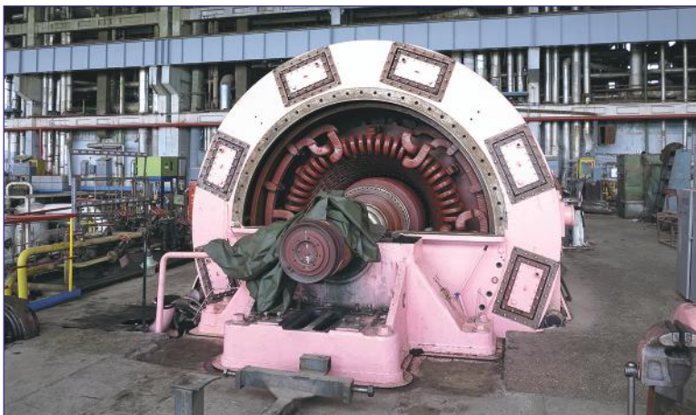
الشكل 22-5 مولد كهربائي مفكك للصيانة.
