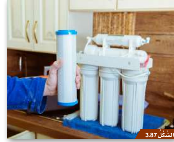
مضفأة مثبتة في تمديدات الماء داخل المنزل
