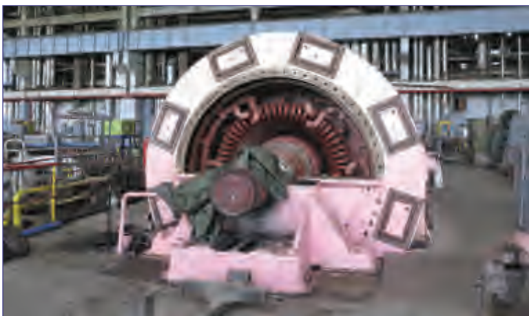
الشكل 22-5 مولّد كهربائي صناعي مفكّك للصيانة.
