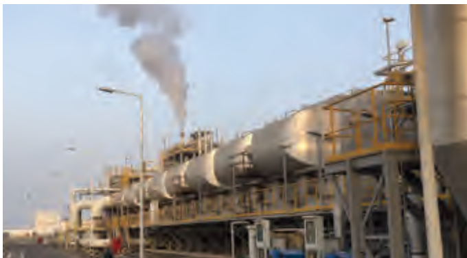
محطة صحار لتحلية المياه بسلطنة عمان
