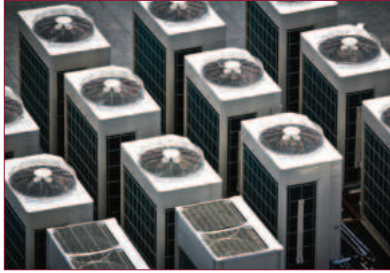
الشكل 38-6 وحدات تكييف الهواء.
