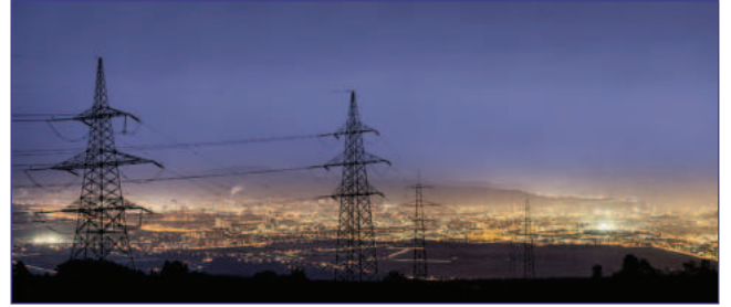
الشكل 5-1 أبراج نقل الطاقة الكهربائيّة عالية القدرة.
